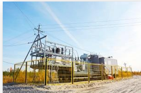
Мобильная модульная подстанция «Самотлорнефтегаз» Фото: «Роснефть»
