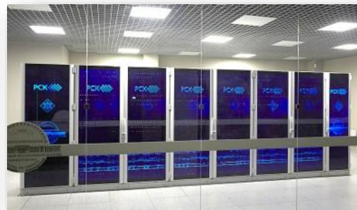
РСК ЦОД для НРС/АИ построен на базе кластерной архитектуры «РСК Торнадо». Фото: Стимул / rscgroup.ru
